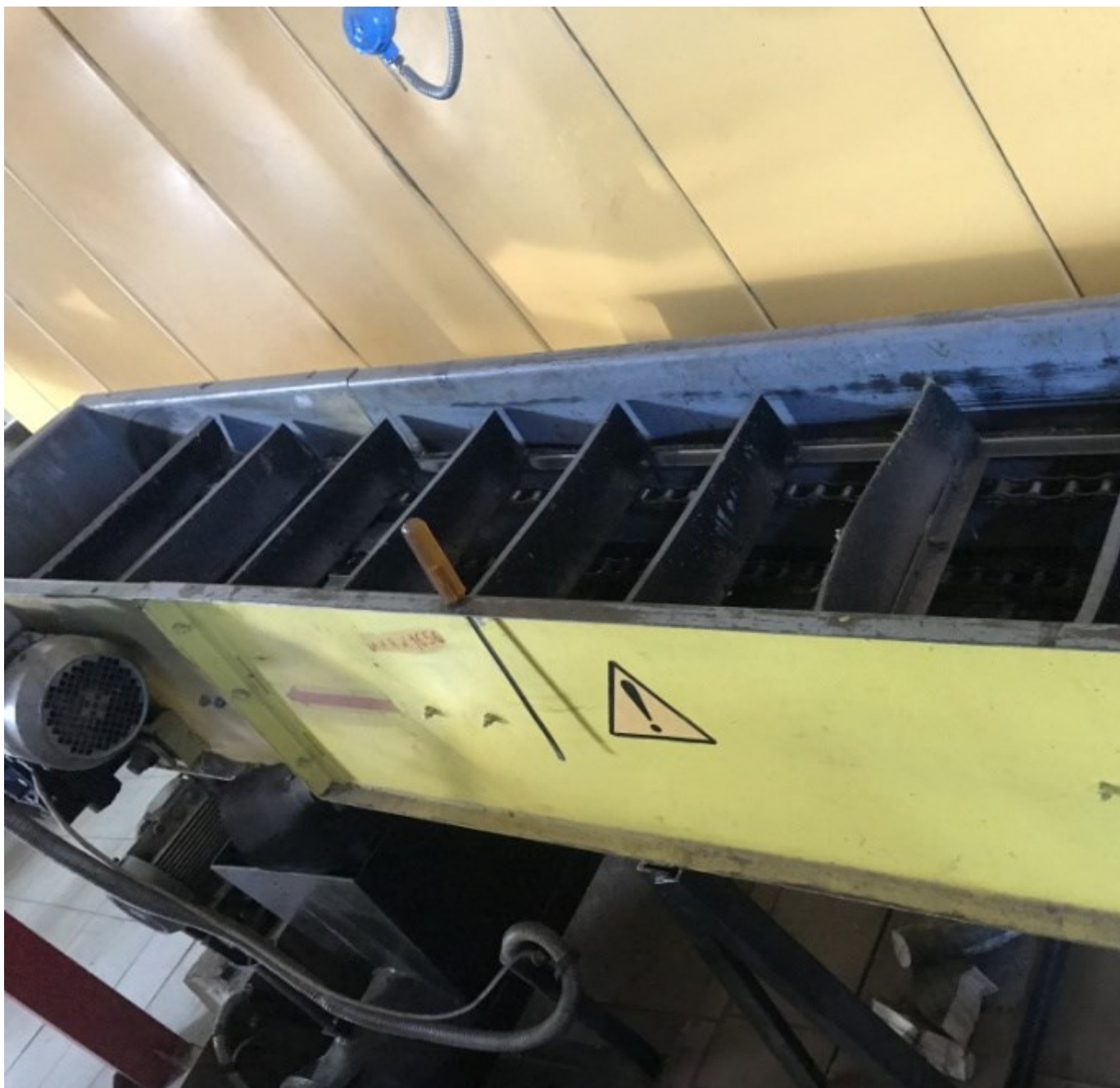
Транспортер скребковый загрузочного котла, расположенный в производственном помещении котельной, не имеет ограждения по всей его длине.
