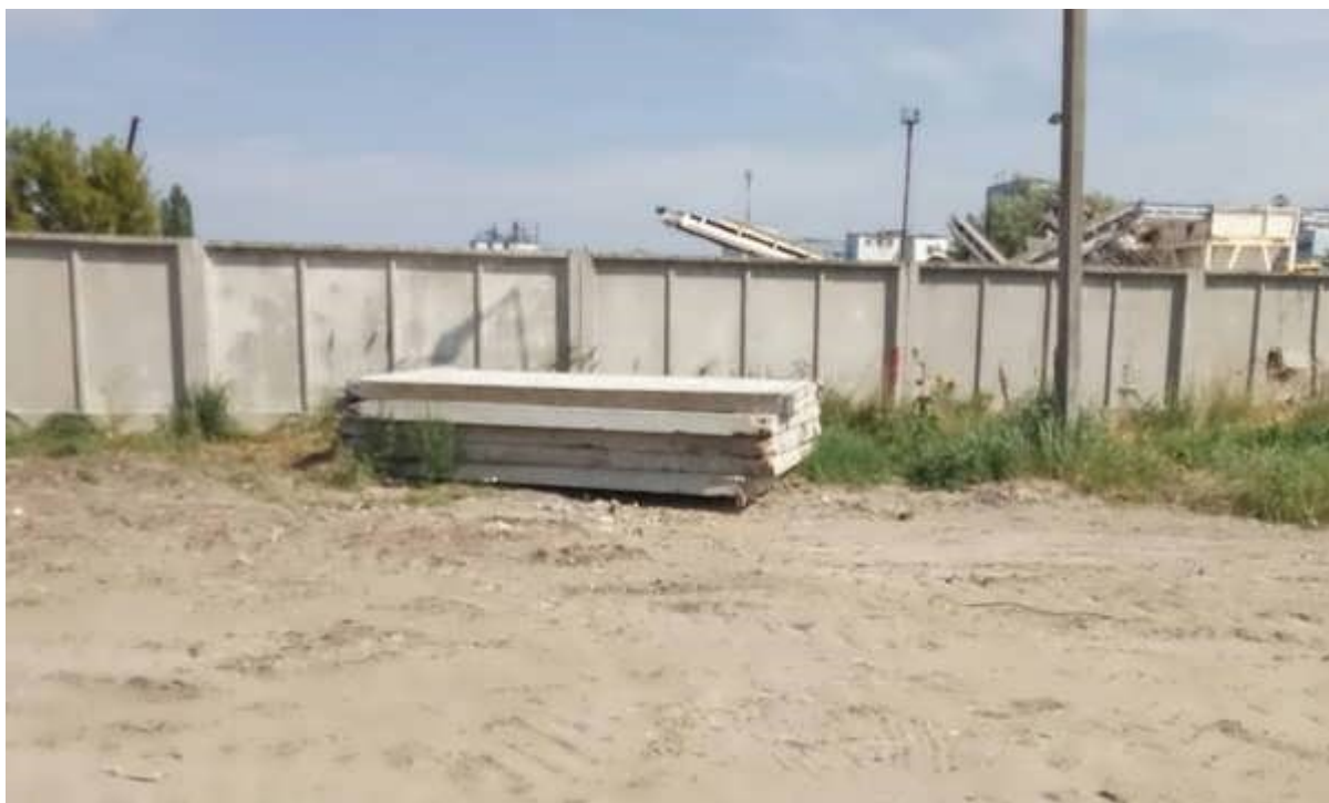
Железобетонные плиты уложены без подкладок и прокладок
