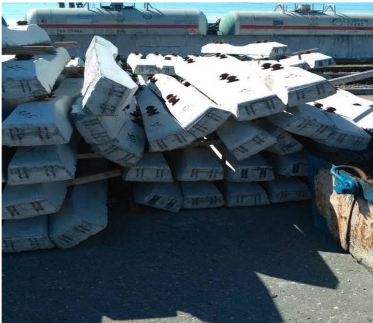
Не обеспечена безопасность складирования грузов
